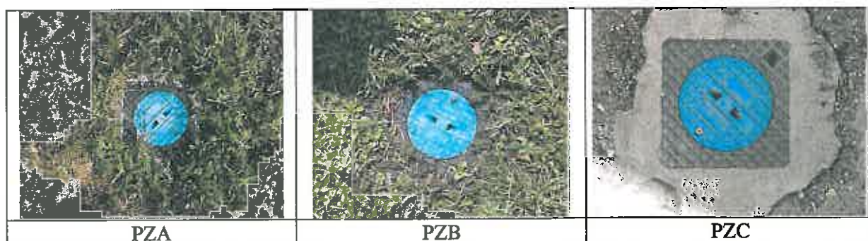
Figure n°5 : Vue des bouches à clef.
